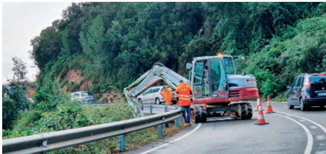
REPARACIÓ D'UN ESVORANC A LA BV-2041 ENTRE BEGUES I GAVÀ PRODUÏT PEL TEMPORAL GLÒRIA | AJUNTAMENT DE BEGUES
