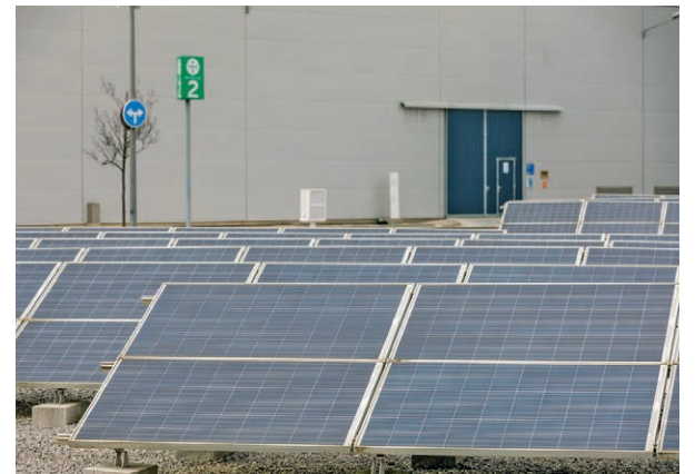
PANELS SOLARS A L'ETAP DE SANT JOAN DESPÍ
