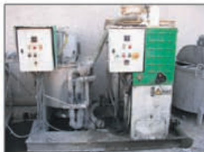
Lote 25 Planta de Inyeccion IPC Mod. GIET4
