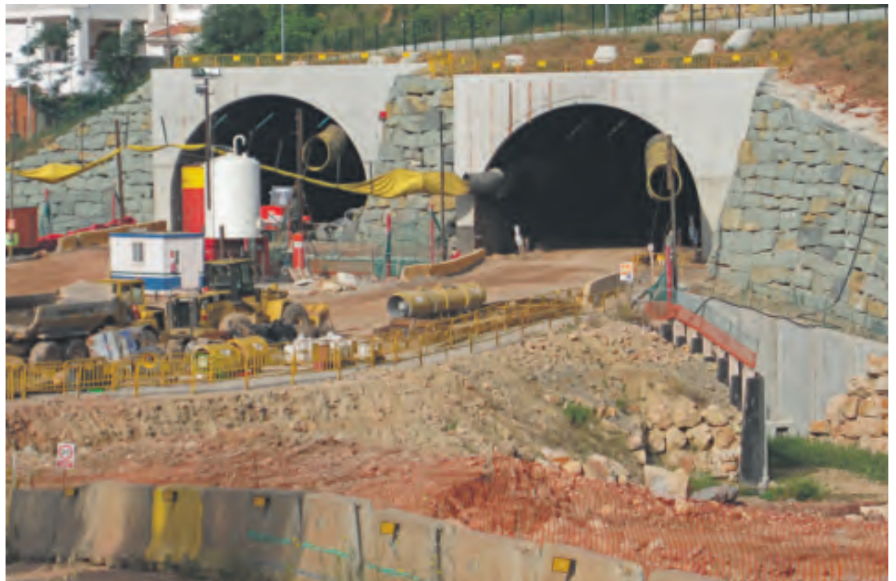
ESTAT DE LES OBRES AL NOVEMBRE DE 2014, JUST QUAN ES VAN REANUDAR DESPRÉS DE TRES ANYS ATURADES | ARXIU
