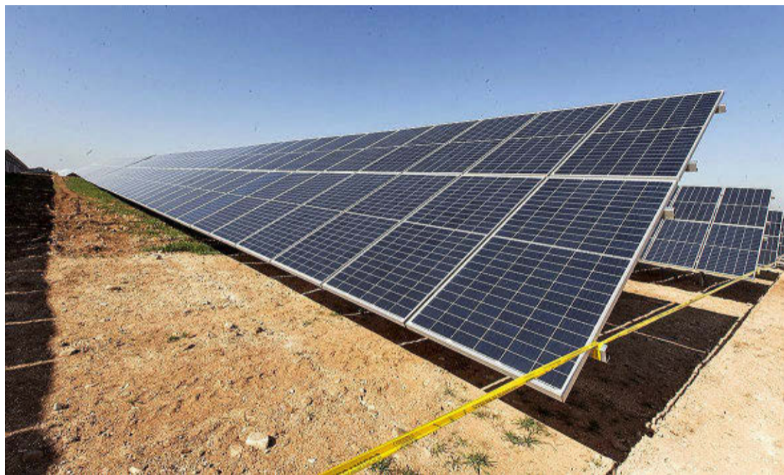
Planta solar instalada en la provincia. / YOLANDA LANCHA
