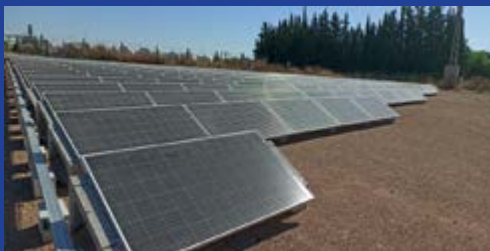
Plantas e Instalaciones Fotovoltaicas
